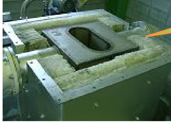
廃熱回収装置
